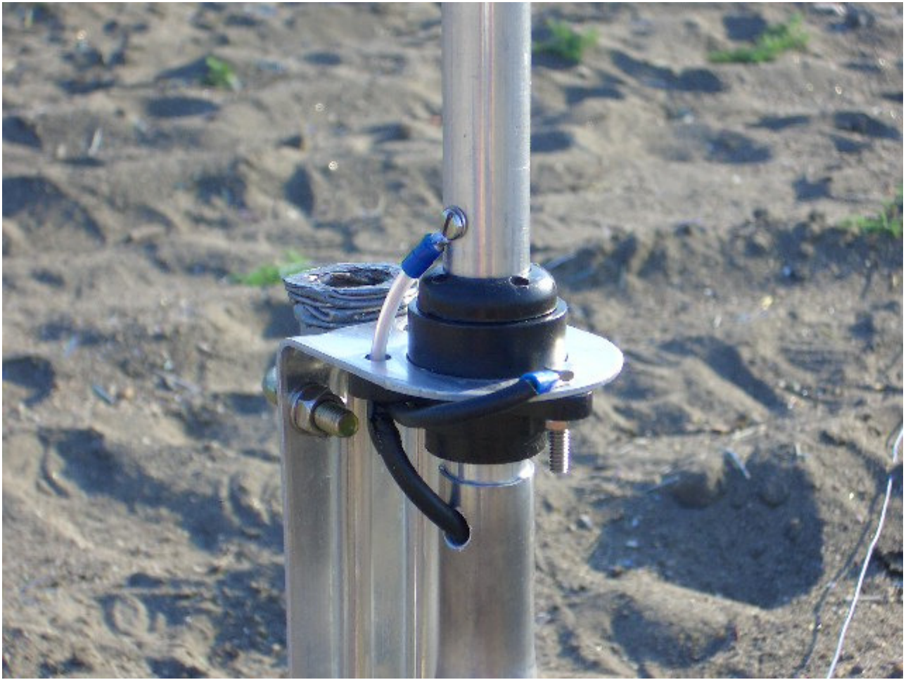
Figura 3 – Collegamento del cavo coassiale alla struttura metallica
